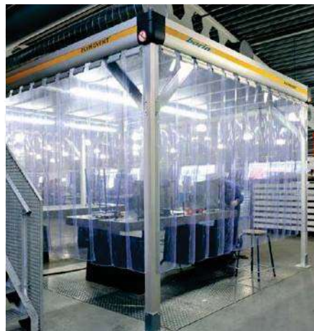
134.-Campana de cabina extractoras de humos.
