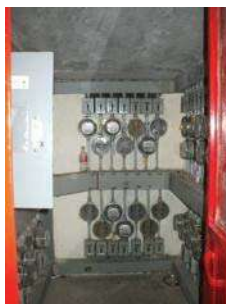
Img. 54. Área de tableros de luz. Fuente: Ibidem.
