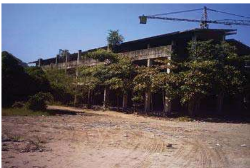
Foto 50. Se observa una construcción (Hotel) en ruinas
