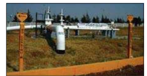
Imagen 20. Apreciación de especificación de una restricción de Pemex.
