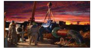
Imagen 19. Apreciación de especificación de una restricción de Pemex.
