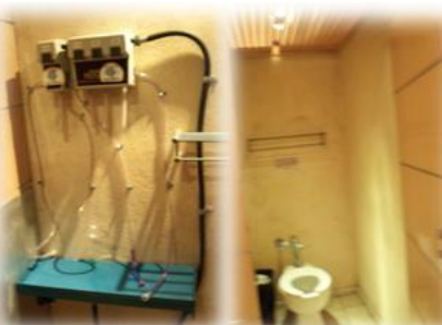
Dispensador de cloro, limpiador de piso, vidrios y desinfectante
