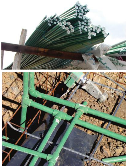
FIG. 75: FOTOS DE TUBOPLUS E INSTALACIÓN HIDRÁULICA.
