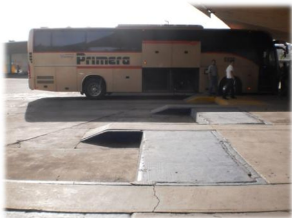
Ilustración 5. Estado actual de una parte del estacionamiento de autobuses. Fotografía tomada por María Carol Ramírez Garcidueñas.
