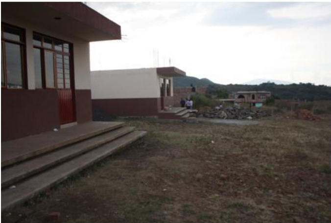
Aulas de la Escuela Primaria. Dos aulas construídas, aunadas al material para la realización de las siguientes.
