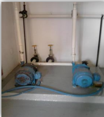
Foto 13: Bombas de 5CV en cuarto de máquinas. ACSU
