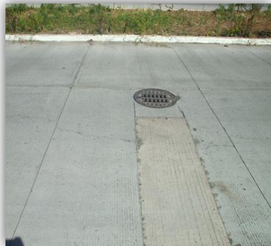
Foto 48: DRENAJE. Foto tomada por Ana Karen Altamirano
