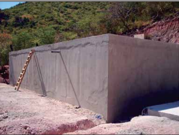
TANQUE DE ALMACENAMIENTO DE AGUA
