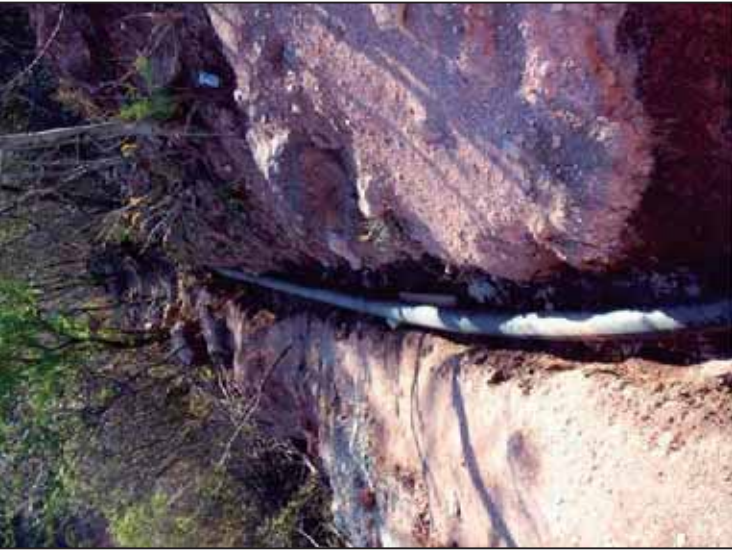
POLIDUCTO PARA RED DE AGUA
