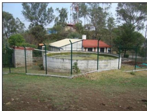
IMAGEN 70.- TANQUE DE CAPTACION PLUVIAL
