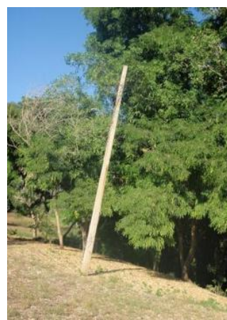
IMAGEN 42.- POSTES DE MEDIA TENSION Descripción: Se ve el poste de media tensión ubicada sobre la vialidad principal a las afueras de las instalaciones del Lago. Fotógrafo: Patricia Anahí Gracián Negrete. Fecha: Octubre/13/2010.
