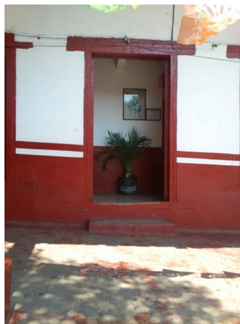
Figura 16 Puerta del registro Civil. Cerramiento de puerta en esta se observa que su marco es de madera, está un poco desgastada en la parte de abajo. José Raúl Velázquez Nambo.
