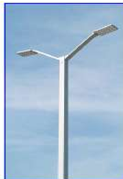
luminaria en poste exteriores
