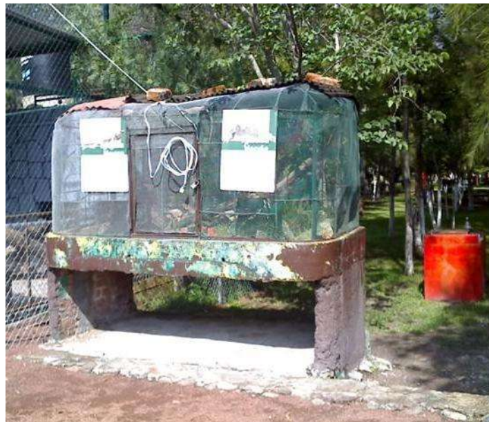
Ilustración 4: Ejemplo del estado actual de las instalaciones eléctricas (In Situ)
