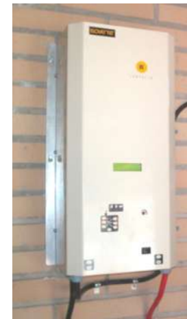
Imagen 34. Inversor de corriente directa a corriente alterna.
