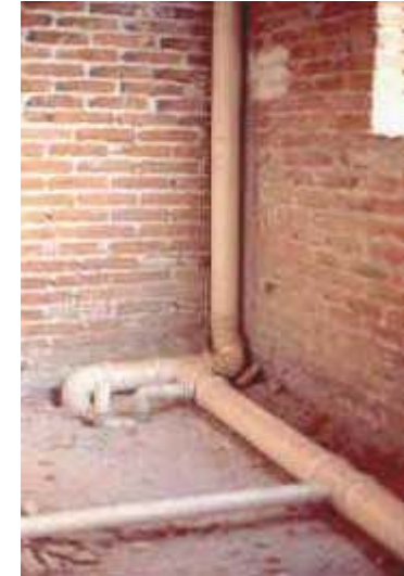
Imagen 28. Instalación sanitaria de PVC. Fuente: la web
