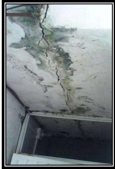
Fig. 4 Ejemplo de grietas en estructura del inmueble actual. (Fuente: archivo fotográfico personal, Daniel Alejandro Orozco Herrera. 2011)
