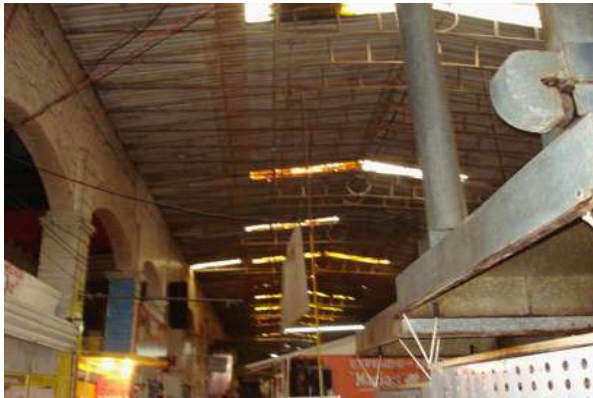
Imagen 5. Deterioro de las instalaciones (cubierta)
