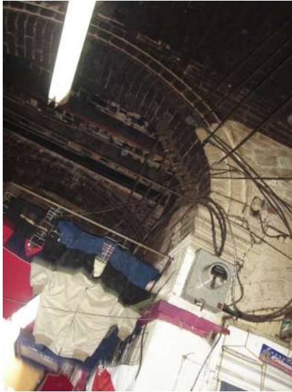
Imagen 7. Instalaciones eléctricas en malas condiciones.
