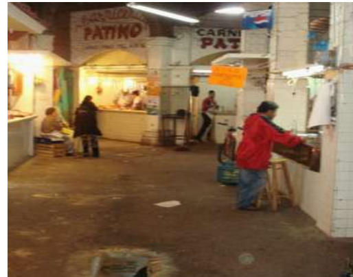
Imagen 6. Alcantarillas en deterioro, interior de mercado
