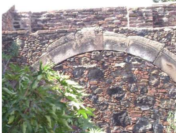
FOTOS: PARTE DE LA ARQUERIA DE LA HACIENDA HA SIDO CUBIERTA
