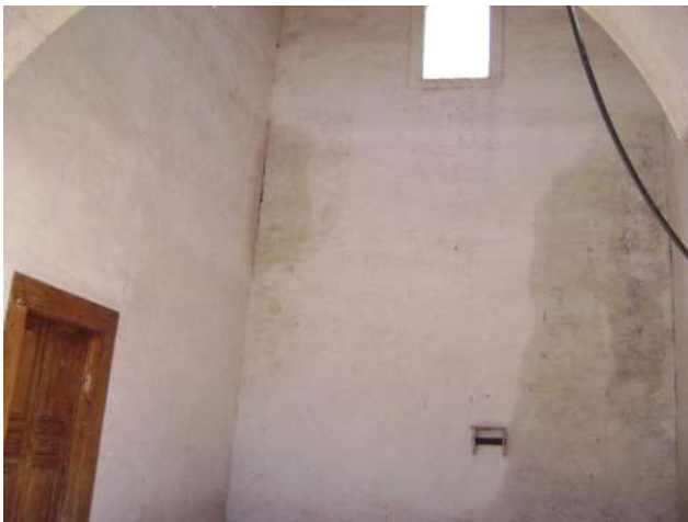
Foto37: Deterioro en las pinturas
