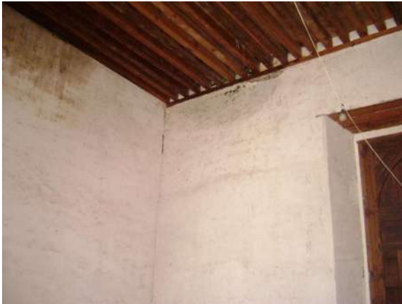
Foto38: Viguera y pintura.
