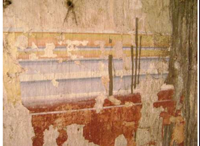
Foto36: Vista de pintura deteriorada en los muros
