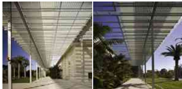
Imagen 7.71 Aleros exteriores con celdas fotovoltaicas.
