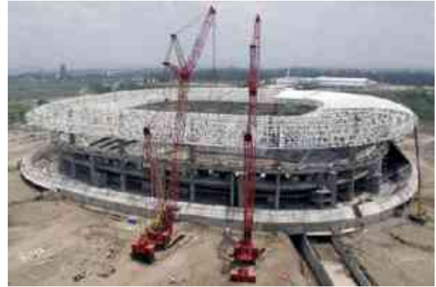
Mapa 1: Montaje de la estructura tubular para la cubierta del estadio Omilife, Zapopan, Jalisco.
