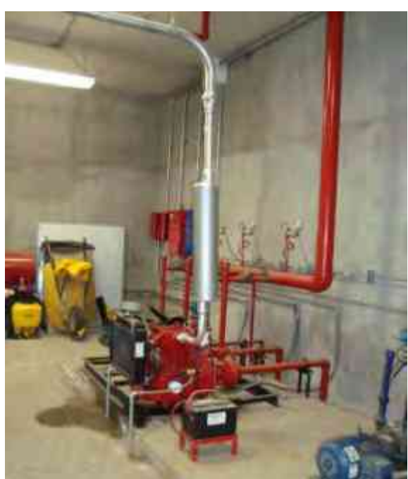
IMAGEN 2.58 – Cuarto de máquinas. Fotografía propia.
