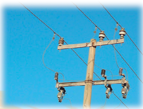
Imag. 16: Vista de un poste de luz donde se abastecerá el conjunto habitacional, G.J. Cervantes Q.
