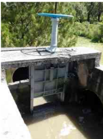
Figura 40. compuerta de demasías, fuente: captura autor.
