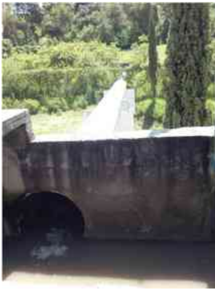
Figura 38. Llegada de aguas residuales, desde colector municipal, fuente: captura autor.
