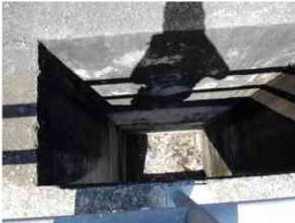
Figura 42.Caja de distribución, modulo "A", fuente: captura autor.
