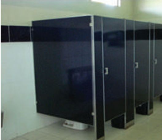
Imagen 51 Modulo de Baños
