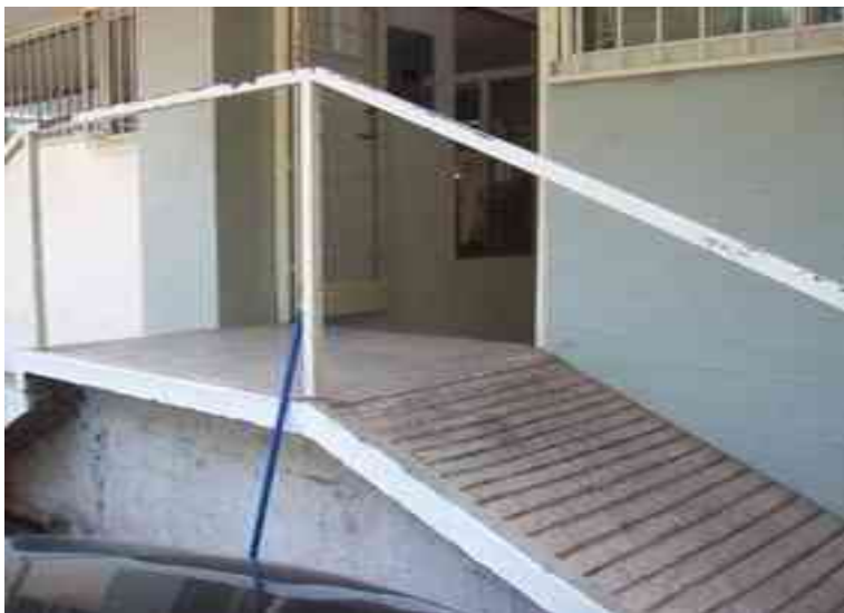
IMG No.26 Acceso para persona con silla de ruedas GTG 23-sep-2011
