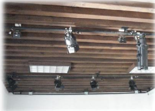
IMAGEN 17. Se muestra el plafón del Auditorio donde se observan las luminarias que apuntan al escenario. El problema radica en el movimiento de las mismas en un concierto del CMMAS, pues es necesaria la incorporación de una escalera para tal efecto. Otro de los problemas resulta en el peso de las luminarias suspendidas en las vigas de madera de la estructura del edificio del ex convento Carmelita; pues no se pueden colocar más luminarias por tal cuestión. Fotografía: Martín Rubio Avalos.
