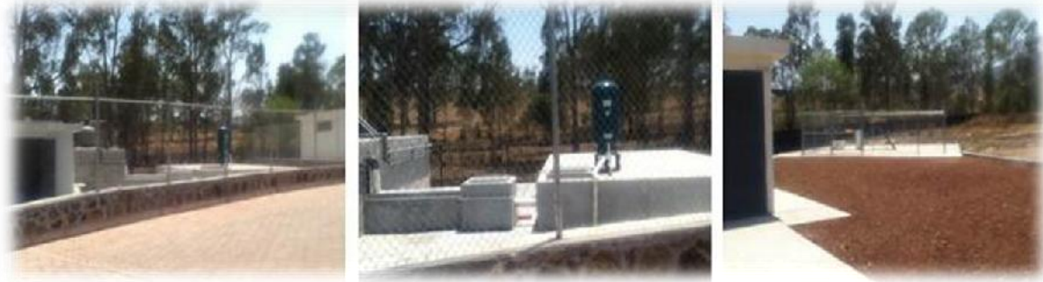
IMAGEN 151. Planta de Tratamiento de Aguas Residuales del campus de la ENES; se ubica en la zona más baja del predio porque el agua llega hasta aquí por gravedad, el agua tratada es enviada nuevamente a los inmuebles que la ocupan. Fotografía: Martín Rubio Avalos.
