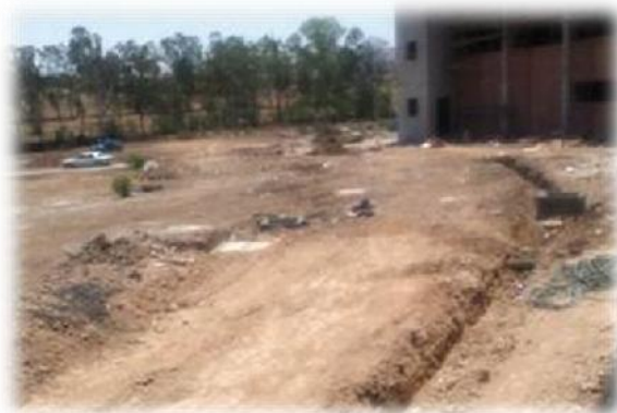
IMAGEN 146. Infraestructura Urbana de la ENES, colocada en la parte posterior de los edificios, con el objetivo de arrojar todas las instalaciones atrás de los edificios y no en sus portadas principales. Fotografía: Ismael Vázquez Betanzos.
