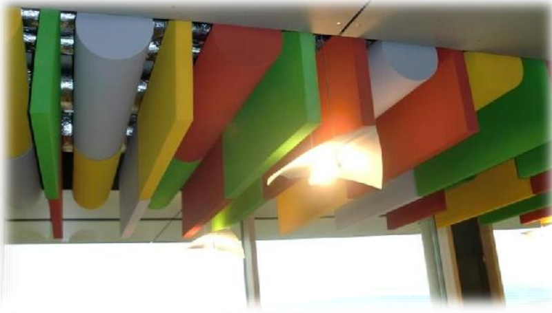
IMAGEN 190. Material absorbente en el plafón de un espacio donde se requería que no existiera reverberación en el interior. El material es a base de espuma de poliuretano de diferentes colores, generando diseños y composiciones agradables y útiles en aspectos de la acústica. Imagen obtenida en: http://www.vulka.es
