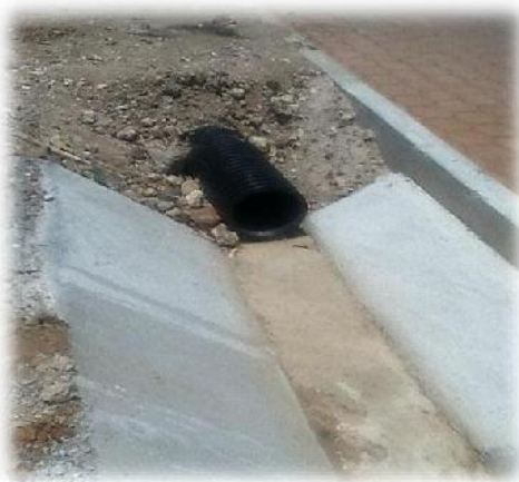
IMAGEN 150. Tubo de instalación sanitaria a base de polietileno corrugado de alta densidad, colocado por debajo de la tierra, dependiendo el nivel de proyecto; la tubería es conectada a la planta de tratamiento para su purificación posterior. Fotografía: Ismael Vázquez Betanzos.
