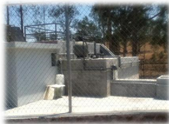
IMAGEN 102. Planta de tratamiento de aguas residuales del campus de la ENES. Fotografía: Martín Rubio Avalos.
