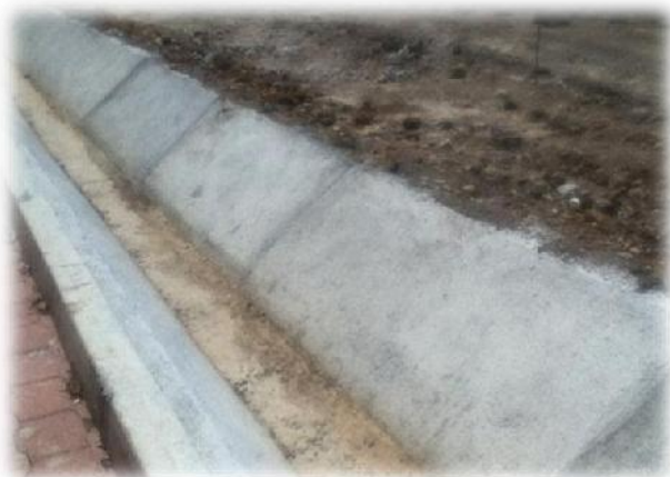
IMAGEN 148. Canales a Cielo Abierto que colinda con el circuito vehicular que rodea la ENES, fue colocado para la captación y circulación del agua de lluvia por gravedad para su futura recolección. Fotografía: Ismael Vázquez Betanzos.
