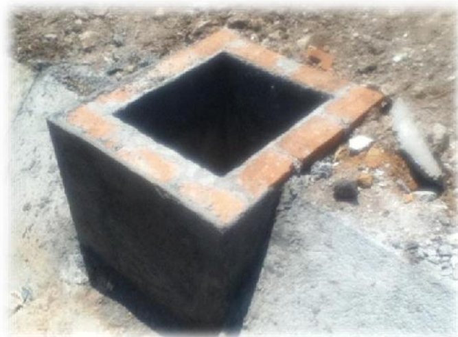
IMAGEN 154. Se muestra uno de los registros de Instalación de Telecomunicación, de donde se conecta el servicio de telefonía fija, cuyas ramificaciones se trasladan a los edificios. Fotografía: Martín Rubio Avalos.
