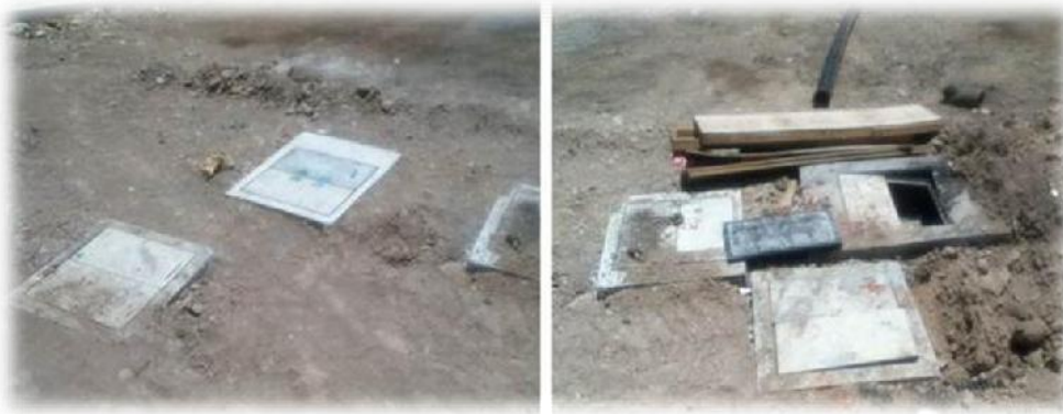
IMAGEN 149. Registros de la Instalación Sanitaria del campus de la ENES, cabe mencionar que cada registro cuenta con su nomenclatura, color y simbología independiente para cada instalación. Fotografía: Martín Rubio Avalos.
