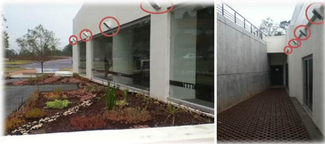
IMAGEN 153. En la imagen se muestran las luminarias de la cafetería que conforman la Instalación de Alumbrado del campus y forma parte de la Infraestructura Urbana Energética de la ENES Unidad Morelia. Fotografía: Martín Rubio Avalos. Imagen editada por: Ismael Vázquez Betanzos.
