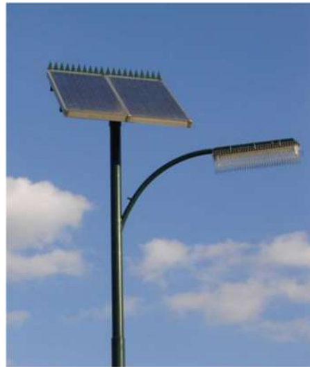
Ilustración 64: Lámpara de celdas fotovoltaicas.
