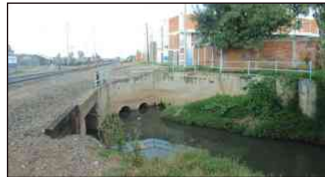
Imagen 65. Drenaje FOTO: TMMG Octubre 2012
