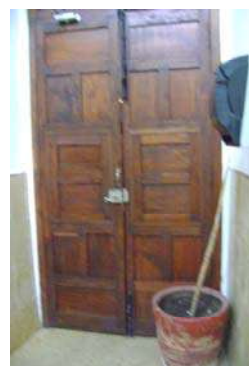
Ilustración 88 Puerta con acceso hacia adentro para sanitarios, obstruida para maseta. Annel Pérez Arroyo
