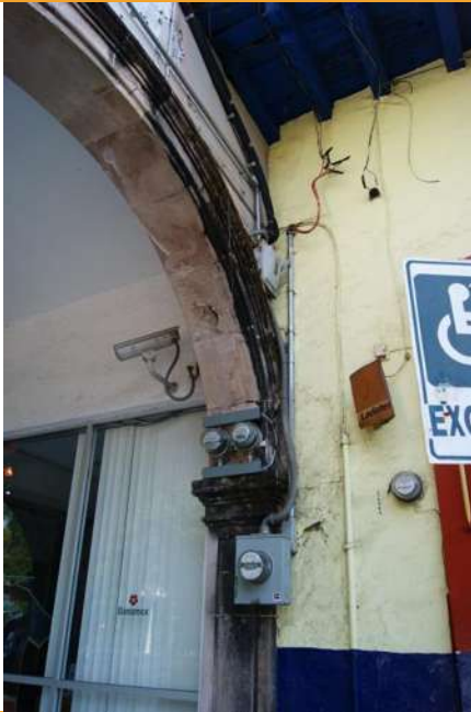
Foto 13. Cajas de medición y cableado visibles y expuestos.
