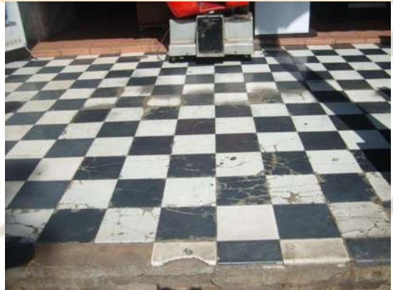
Foto 10. Deterioro en pisos.
