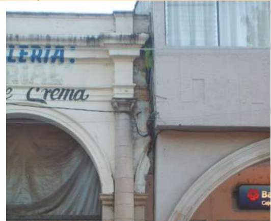
Foto 18. Fractura de discontinuidad de la arquería original
