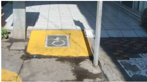
Imagen 41. Rampa de acceso al portal para discapacitados. Fotografía tomada por el autor.
