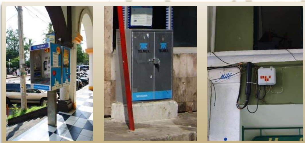
Imagen 48. Casetas telefónicas y cajas de registro de líneas. Fotografías tomadas por el autor.
