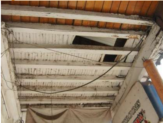
Foto 9. Notable deterioro en plafones.
