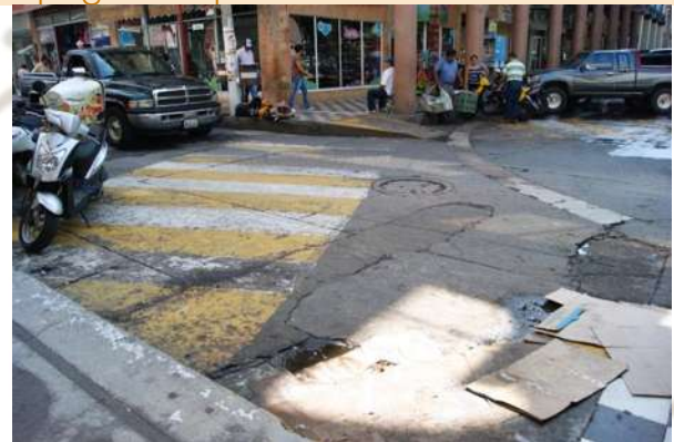
Foto 16. Mal estado de pavimento y pintura en paso peatonal.
