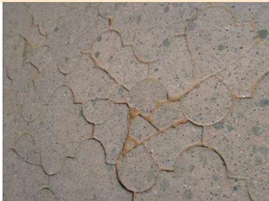
Foto 5. Deterioro en adoquín.
