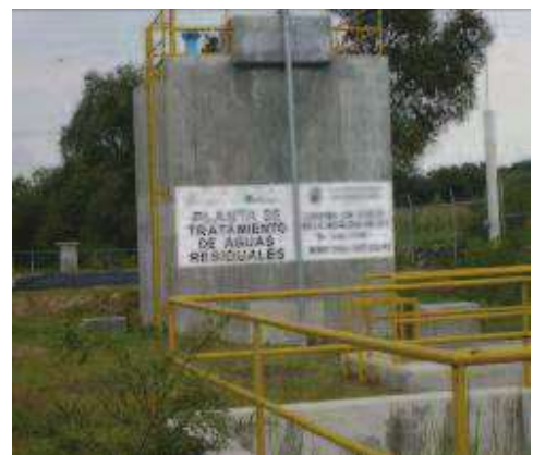
Foto N° 13. La planta tratadora de aguas residuales se encuentra a 259 m del terreno propuesto.
