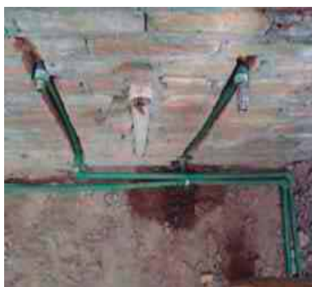
Ilustración 61 Tubería hidráulica, obtenida de www.google.com/images
