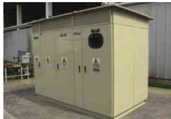
IMAGEN 107: SUBESTACIÓN ELÉCTRICA TOMADO DE: HTTP://ALFASUBESTACIONESELECTRICAS.BLOGSPOT.MX/
