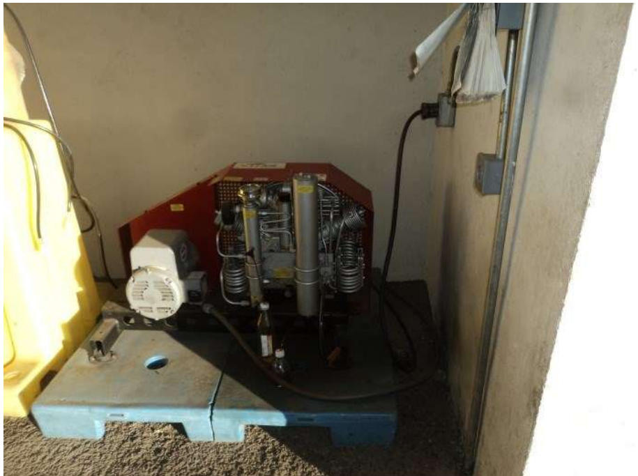
Fotografía 3.23.- Estación Bomberos 1, Leon, Guanajuato, Bodega de Equipo de Oxígeno, ArqYoy_F (2013), Archivo Personal.
