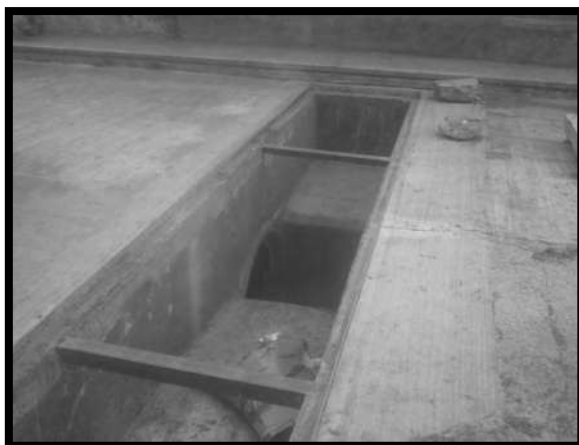
Imagen 50. Red desagüe pluvial. S. Galván H.
