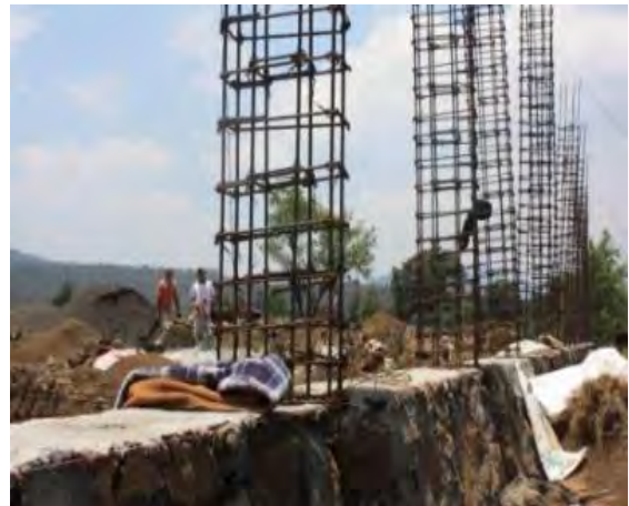
Imagen 41. El armado de columnas y su colocación se realiza desde las zapatas corridas. Ortiz Amaya, Santiago (2012). "Armado de Columnas". Morelia, Michoacán.
