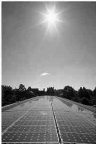
Imagen 54. Fotoceldas instaladas sobre losa 81
