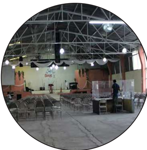
3. Vista interior del recinto que funciona como sala de culto. Se observa la escasa infraestructura con la que cuenta.
