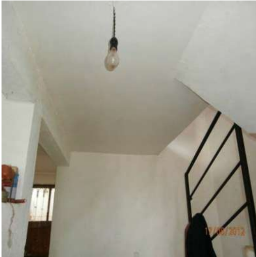
Fotografía 12.- instalación eléctrica interior.
