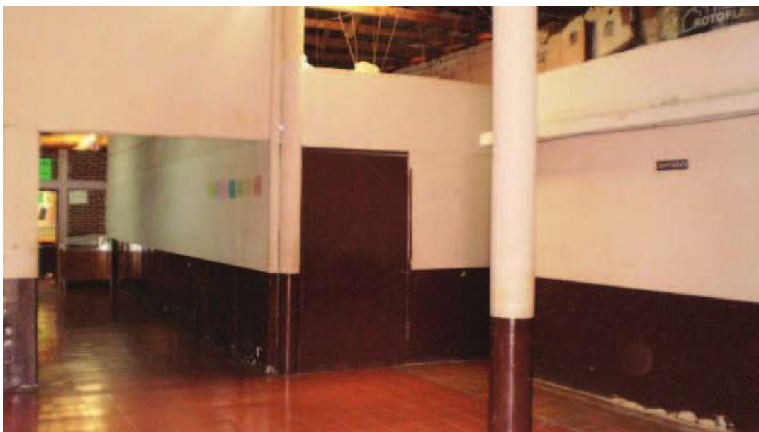
Fig. 55 Interior del inmueble a demoler para la construcción de la casa de la cultura donde se muestran las malas condiciones de este, fotografía resultado de investigación de campo del autor
