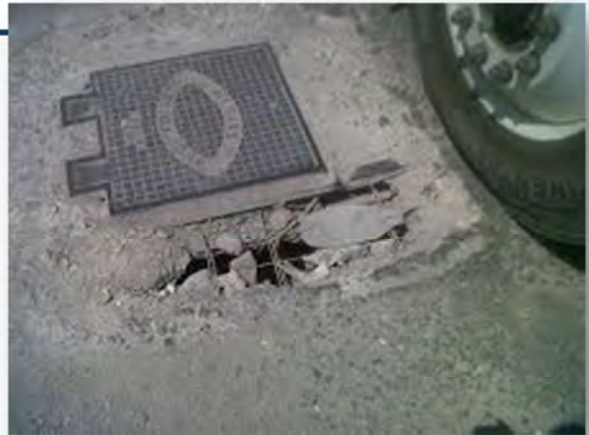
IMAGEN 35 INFRESTRUCTURA DE AGUA POTABLE TARÍMBARO MICHOACÁN FOTO: KARLA VERÓNICA RESCALA ORTIZ [MAYO 2013]
