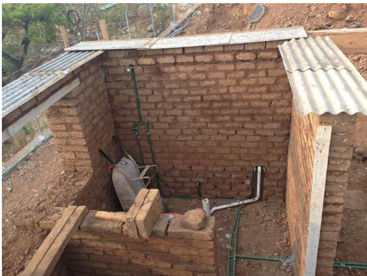
fotografía: Francisco López (2013), instalaciones hidrosanitarias, Ichupio, Mx.
