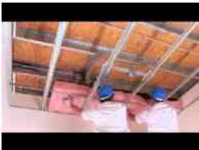
Ilustración 64. Sistema Acústico en Plafón.
