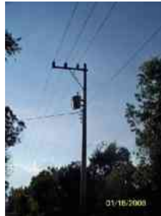
Ilustración 25 Poste de CFE, en la calle camino de la arboleda, por Jonathan Mata H.
