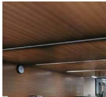
Plafon acústico Channeled de Armstrong Ubicado excepto en foro y aulas
