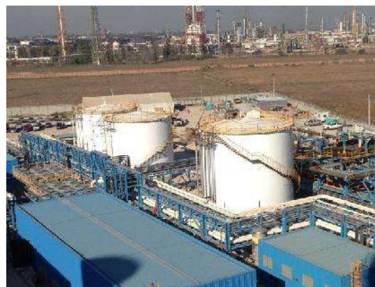
Fig. 45 Tanques de Almacenamiento de Agua Foto del Proyecto Salamanca
