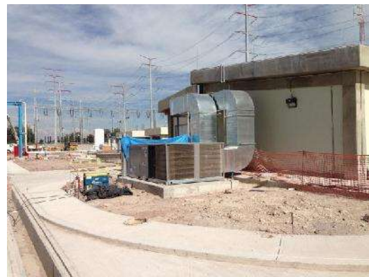
Fig. 58 Sistema HVAC Foto del Proyecto Salamanca
