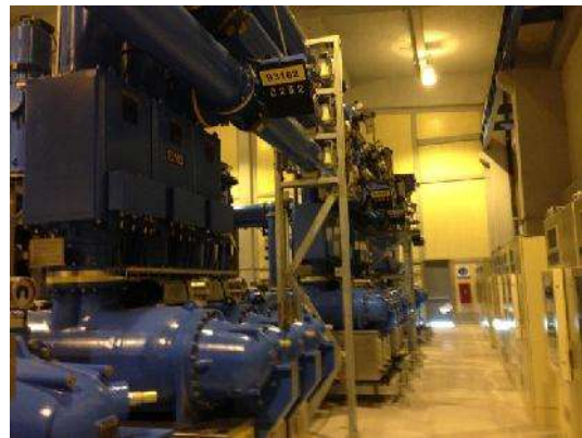
Fig. 71 Bahías Interior de la Subestación Foto del Proyecto Salamanca
