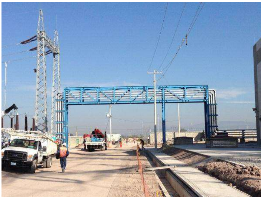
Fig. 20 Estructura Metálica Rack Subestación Foto del Proyecto Salamanca
