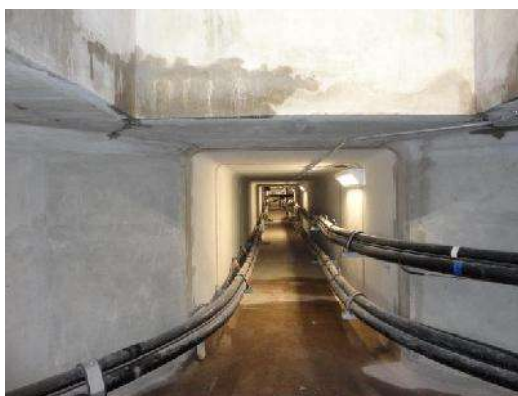
Fig. 74 Cables de Potencia en Galerías Subestación Foto del Proyecto Salamanca
