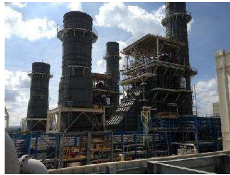
Fig. 1 Calderas de Potencia Foto tomada del proyecto 261 Salamanca
