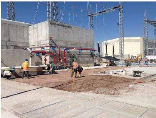
Fig. 70 Pórticos Subestación Foto del Proyecto Salamanca
