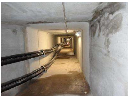
Fig. 75 Cables de Potencia en Galerías Subestación Foto del Proyecto Salamanca
