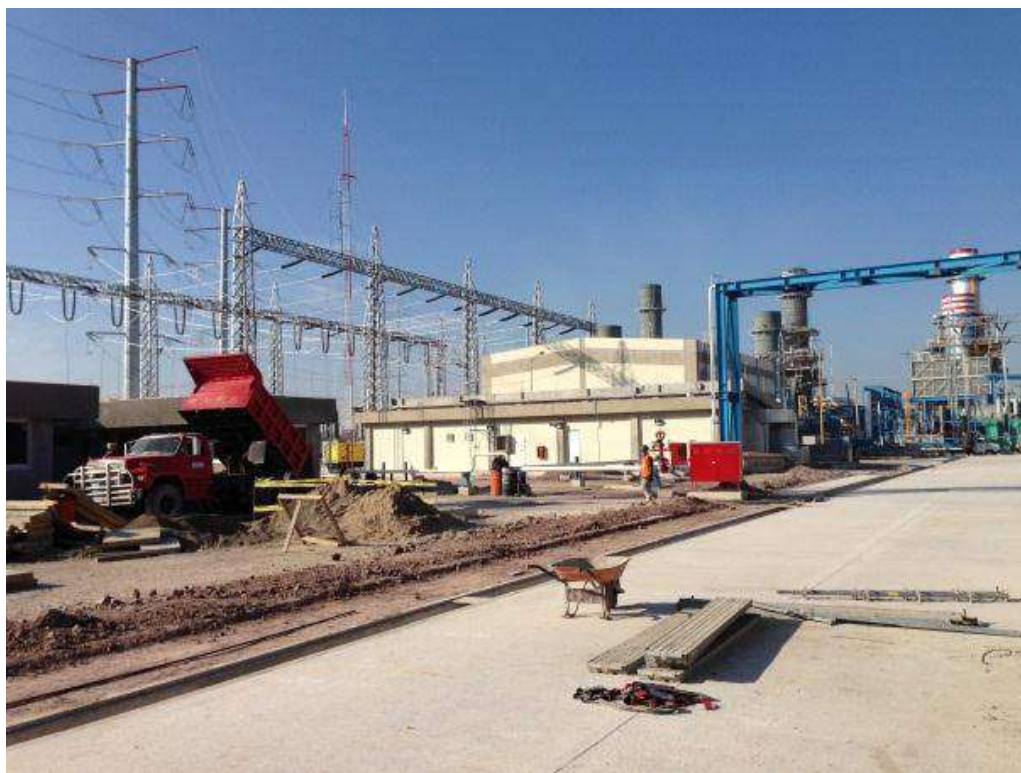
Fig. 73 Subestación Foto del Proyecto Salamanca
