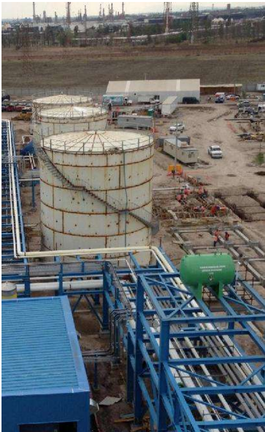
Fig. 44 Tanques de Almacenamiento de Agua Foto del Proyecto Salamanca
