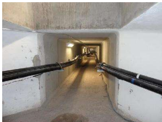
Fig. 76 Cables de Potencia en Galerías Subestación Foto del Proyecto Salamanca
