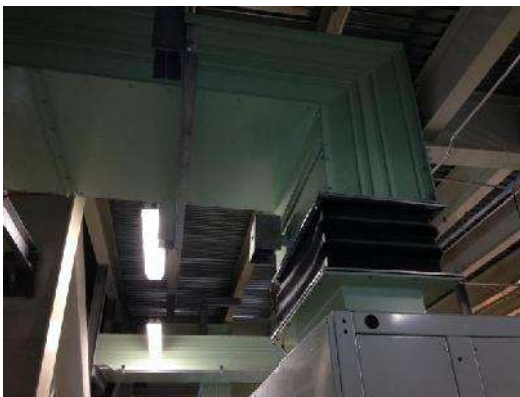
Fig. 57 Sistema HVAC Foto del Proyecto Salamanca
