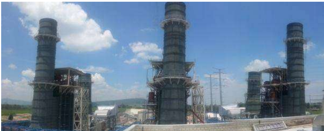
Fig. 43 Calderas Unidad 1,2 y 3 Foto del Proyecto Salamanca
