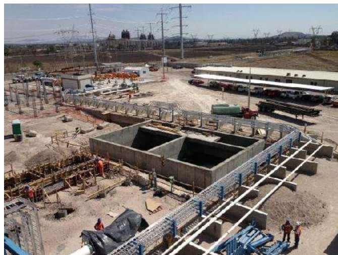
Fig. 17 Balsa de Efluentes Foto del Proyecto Salamanca
