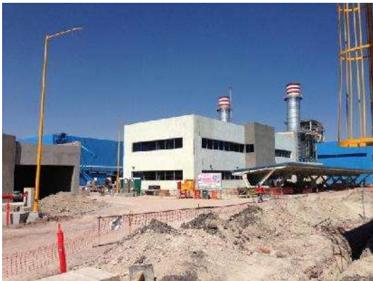
Fig. 68 Instalación de Alumbrado Exterior Foto del Proyecto Salamanca
