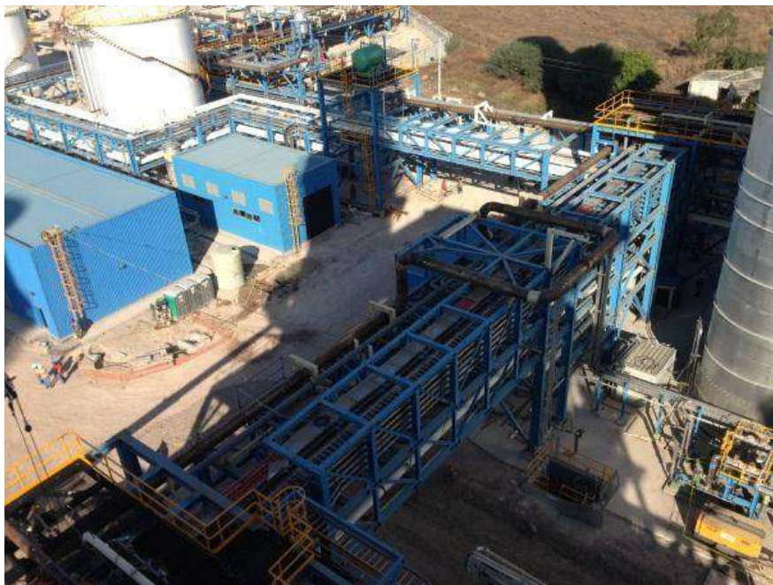
Fig. 21 Estructura Metálica Rack Isla de Potencia Foto del Proyecto Salamanca
