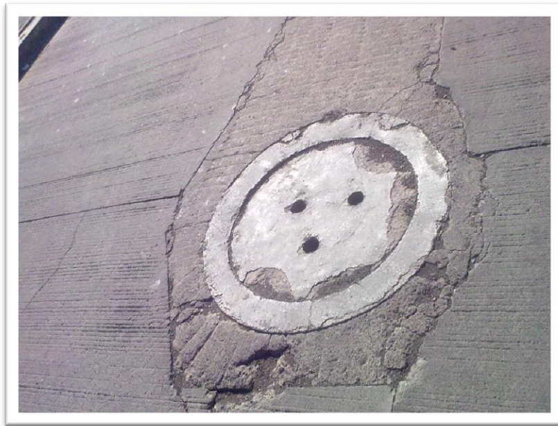
Imagen 35.- drenaje y alcantarillado. Fotografía: Genaro-José (2013) Tarímbaro
