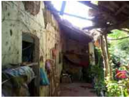
Imagen 22. Casa en deterioro, en el centro de Tuzantla. Foto: Edgar Palomino
