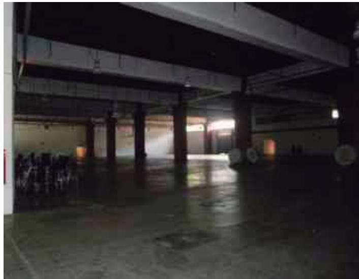
Imagen 43, fotografía del interior del Expocentro, donde se aprecia la carencia de un espacio apto, y de mantenimiento
