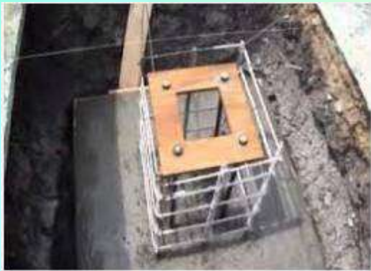
Fig. 29, Unión de Columna de Acero con Zapata, Foto EDGM
