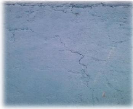
Figura 9 Grieta de muro lateral. Foto tomada por Elizabeth Negrete Herrera. 05/12/2013
