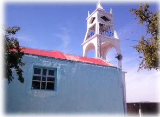
Figura 7 Grietas de la parte lateral de la Capilla de Toluquilla. Foto tomada por Elizabeth Negrete Herrera. 05/12/2013
