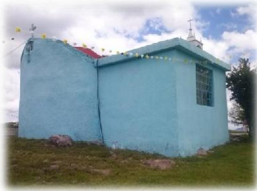
Figura 6 Grietas de la parte posterior de la Capilla de Toluquilla. Foto tomada por Elizabeth Negrete Herrera. 05/12/2013
