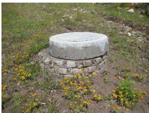
Ilustración 33. Servicios urbanos. De alcantarillado y agua
